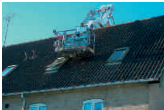
Liften med knækarm på bagside af bygning
